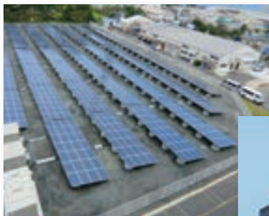
太陽光発電所外観
