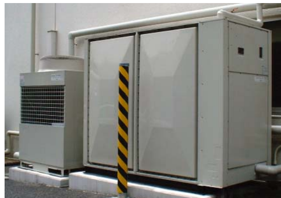
右が蓄熱槽、左はコンプレッサーが入っている室外機
